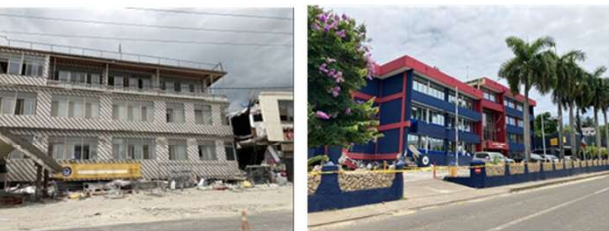
建物の損壊（パンケーキクラッシュ） （左：中華系ホテル） （右：米・英・NZ大使館入居ビル）
