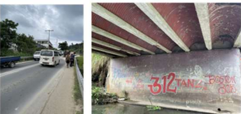
空港と中心市街地を結ぶタガベ橋の損傷 ※今後、重量制限、速度制限の意向
