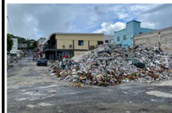
がれき処理/建物判定
