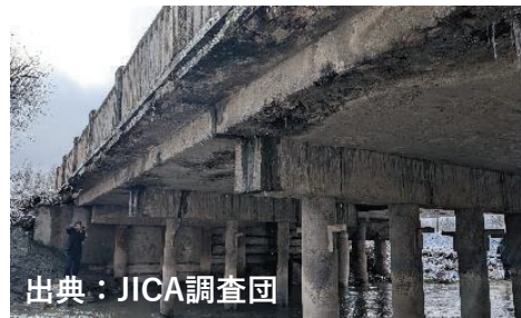
《No.1：劣化した桁の状況》
