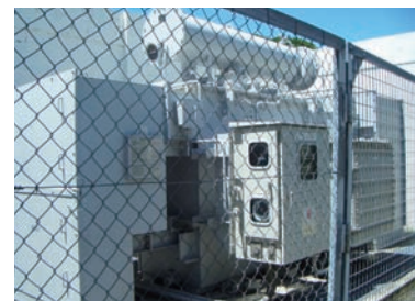
主変圧器（ラナディ変電所）
