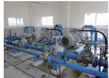
アダシアポンプ場
