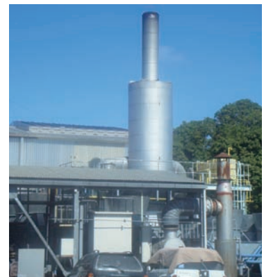
排気塔（ルンガ発電所）
