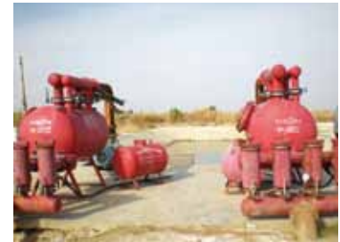
くみ上げポンプと肥料混入機械 (沙湾)
