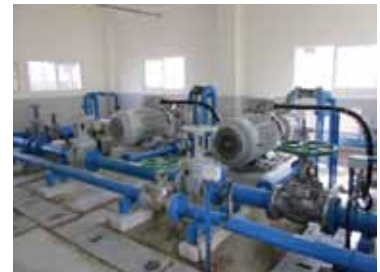
アダシアポンプ場
