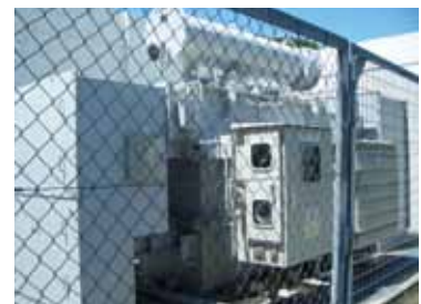
主変圧器（ラナディ変電所）
