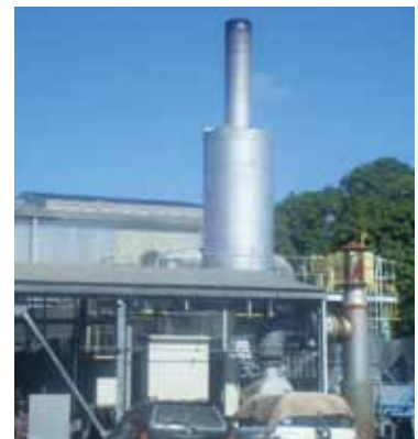
排気塔（ルンガ発電所）
