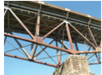
旧橋のトラス部材(錆びが発生)
