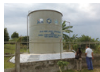
南ダバオ州LGUに設置された給水施設
