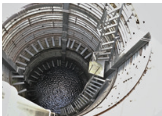
エル・ベリンチェ地区の集水井とその内部（扇状に配置された集水ボーリング工が見える）
