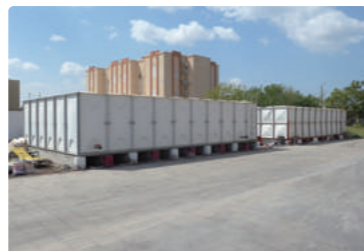
消防署内の貯水タンク
