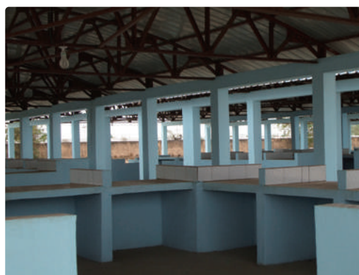
鮮魚小売人用ハンガー内部（2017年から2018年にかけて、市場活性化のために中央魚市場庁が建設）
