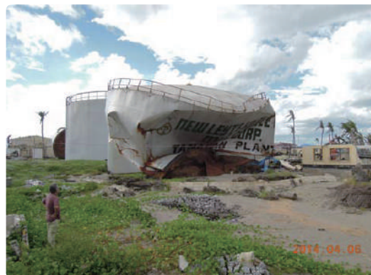
台風で横転したココナッツオイルタンク。台風の威力のすさまじさが分かる
