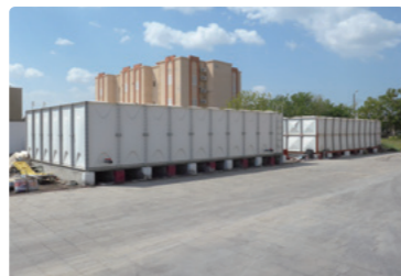
消防署内の貯水タンク
