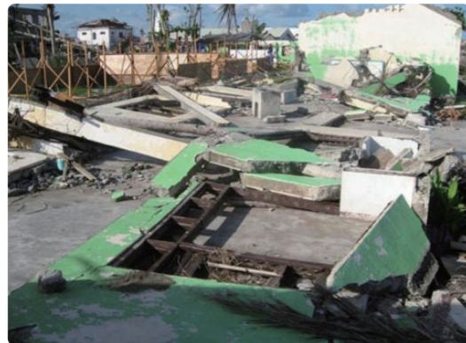
強風に加え高潮により崩壊した校舎
