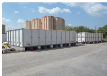
消防署内の貯水タンク
