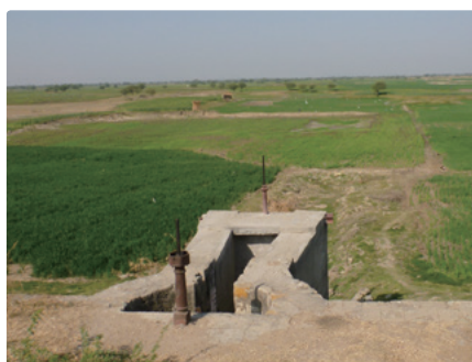
ダム取水設備
