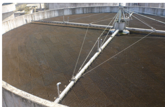
下水処理場（散水ろ床部分）
