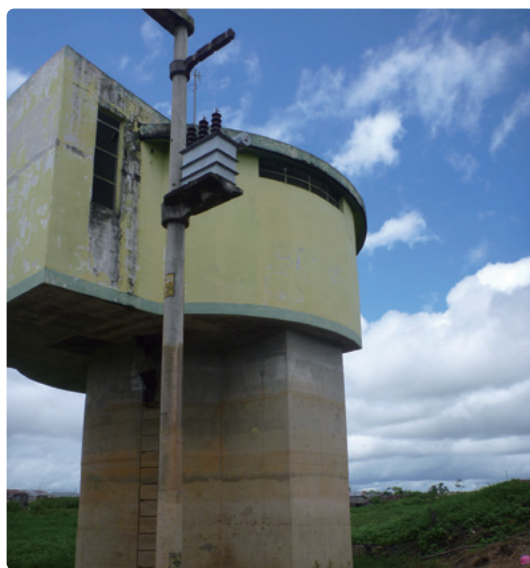
本事業で建設したポンプ場
