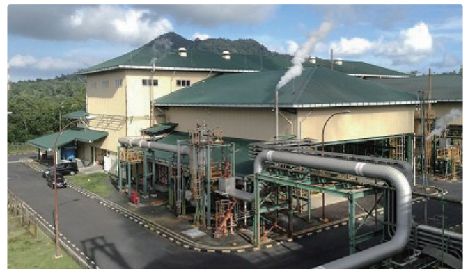
インドネシア・ラヘンドン地熱発電所（外観）
