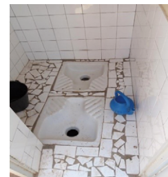
ケドゥグ州マコ村の学校に設置されたトイレ維持管理が行き届いている
