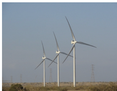
ペルー「エネルギー効率化インフラ支援プログラム」で融資を受けた風力発電所
