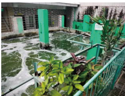
バングラデシュ「中小企業振興金融セクター事業」で融資を受けて整備された輸出用衣料クリーニング設備の排水処理施設
