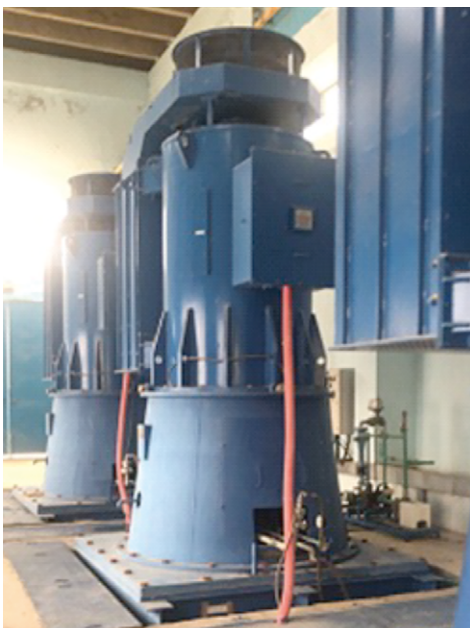
本事業で整備された排水ポンプ
