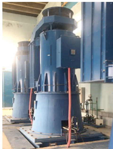
本事業で整備された排水ポンプ
