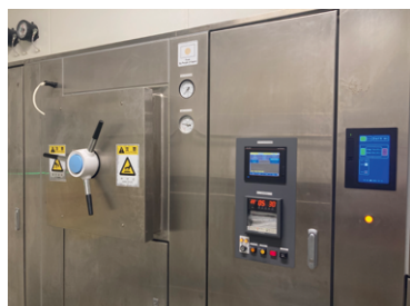
オートクレーブ (滅菌処理の機械)
