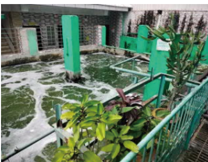
Bangladesh「中小企業振興金融セクター事業」で融資を受けて整備された輸出用衣料クリーニング設備の排水処理施設
