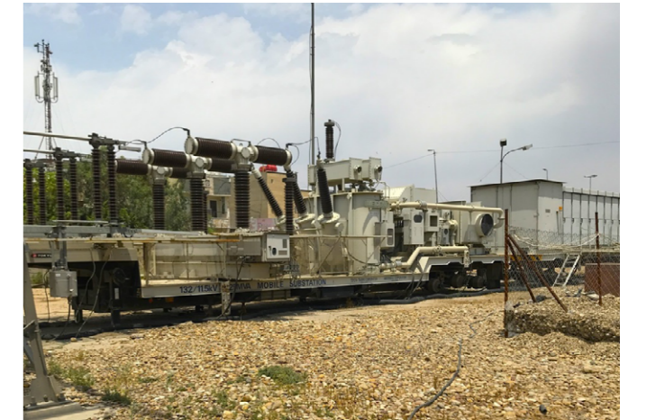
移動式変電所
