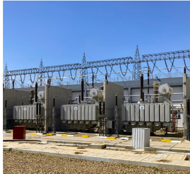
新設された400kV変電所
