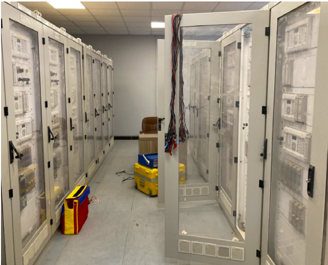
新設された400kV変電所（点検中の制御装置）
