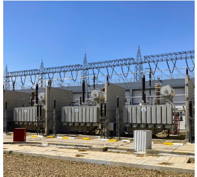
新設された400kV変電所
