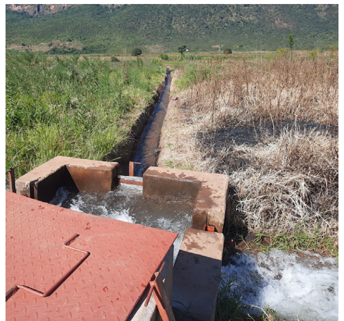
新設された灌漑施設
