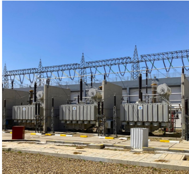
新設された400kV変電所
