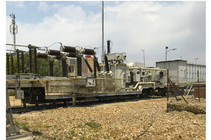
移動式変電所
