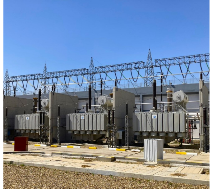
新設された400kV変電所
