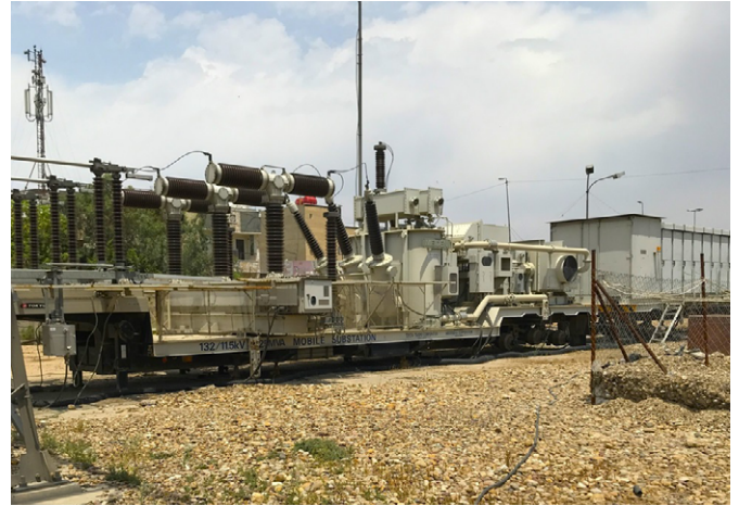
移動式変電所
