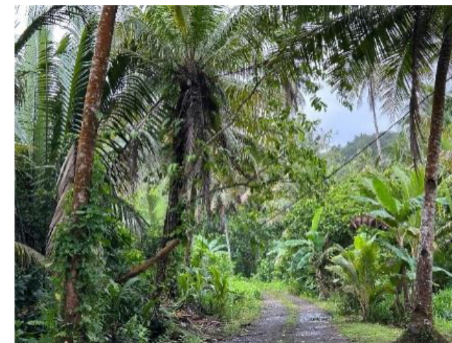
植物に覆われた配電線の様子（撮影：外部評価者）
