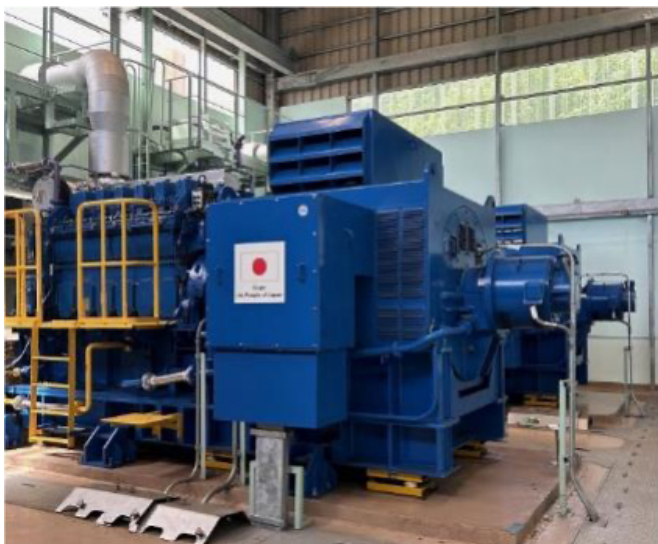
設置された発電機（撮影：外部評価者）
