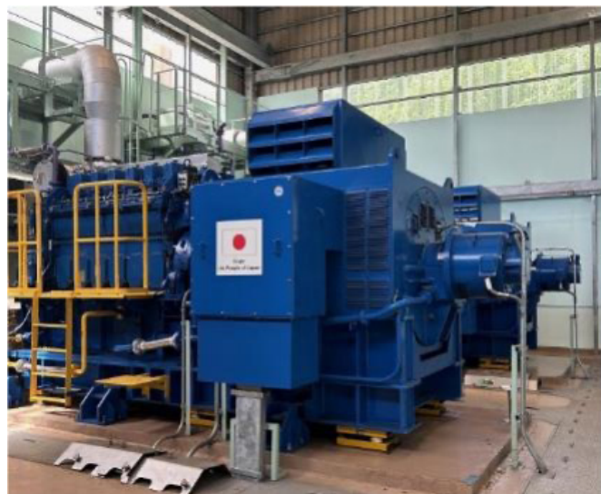
設置された発電機（撮影：外部評価者）
