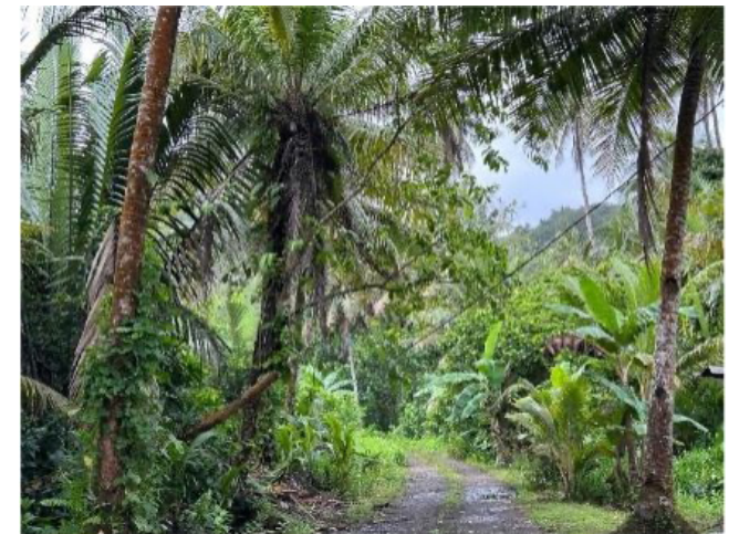
植物に覆われた配電線の様子（撮影：外部評価者）
