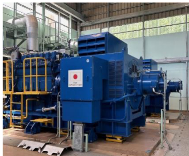
設置された発電機(撮影:外部評価者)
