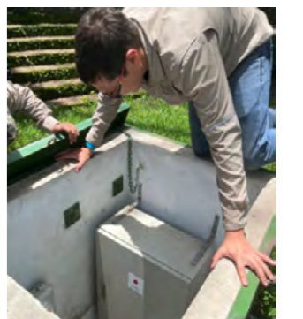
本事業により調達された機材の点検を行う環境天然資源省技師と維持管理ユニットチーム(事後評価現地調査中に撮影)
