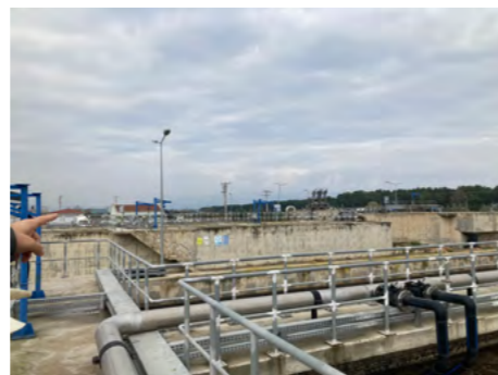
整備された下水道処理施設(ブルサ県オルハンガジ)
