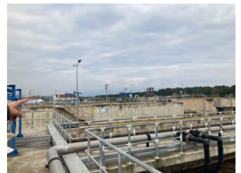
整備された下水道処理施設(ブルサ県オルハンガジ)
