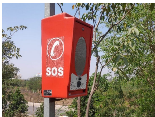
外環道路の緊急コールボックス
