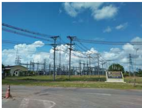
サラワン変電所
