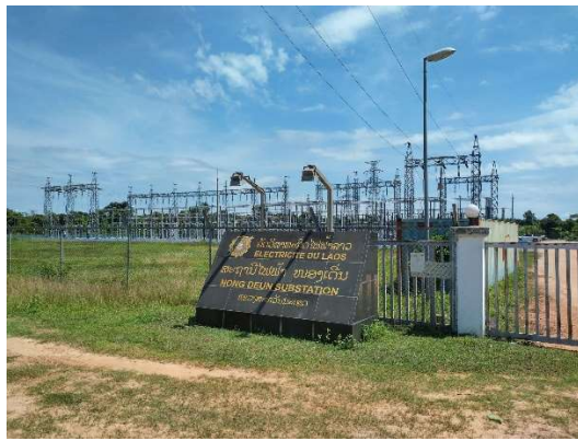
ノンデン変電所
