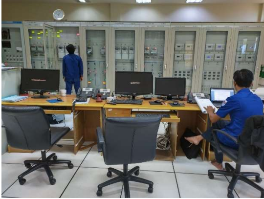
サラワン変電所の制御室
