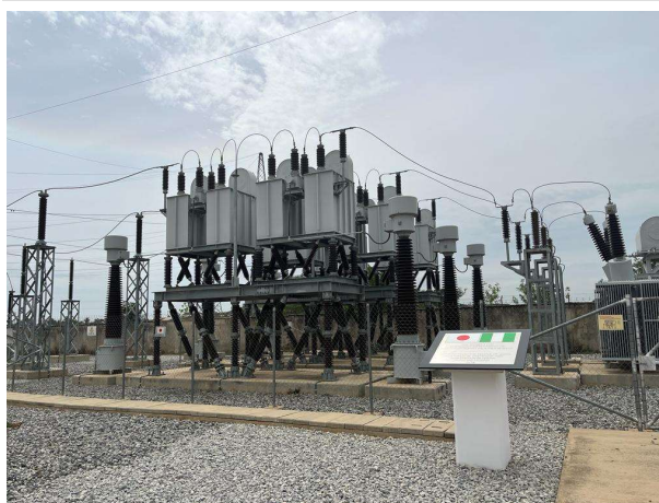
本事業で設置した電力用コンデンサ設備 (出典：外部評価者)
