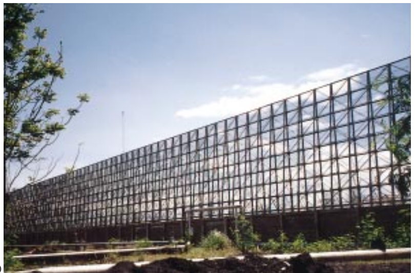
貯炭場の東西に建設された 高さ20mの防塵フェンス (円借款「1号機環境改善事業」により建設)
