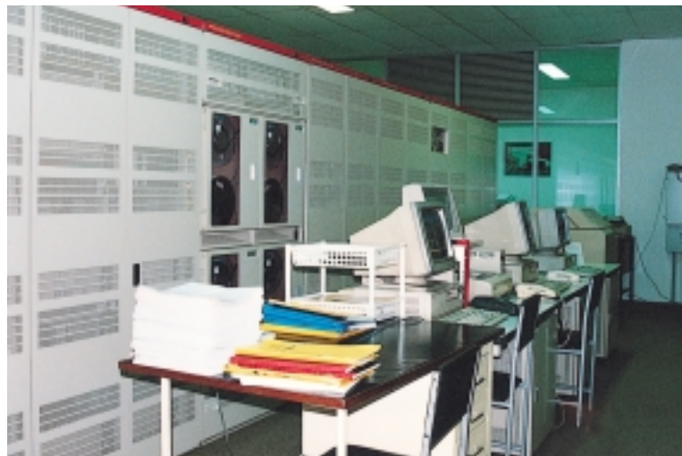
6,000回線分を接続しているデジタル交換機。
