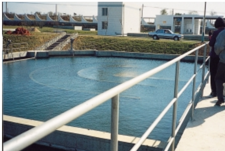
下水処理場 半回分式オキシデーションディッチ法
