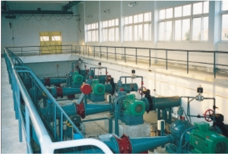
高家台浄水場 ポンプ場
