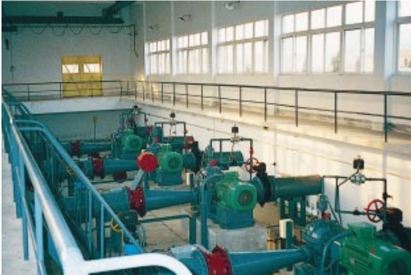
高家台浄水場 ポンプ場
