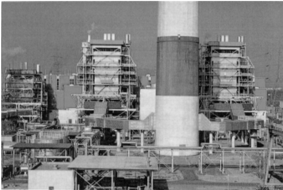
発電機（左：3号機、右：4号機）
