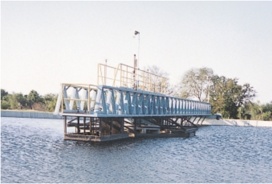
ノレステ下水処理場の二次沈殿施設
