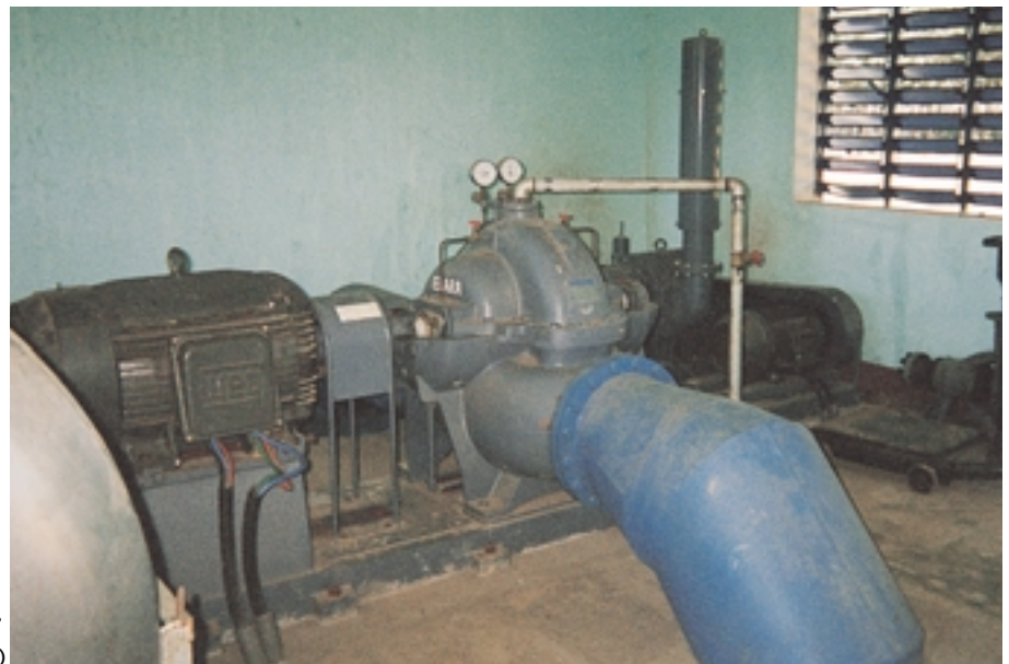
本借款により調達された大型ポンプ（ク・アンチ省、地下水を汲み上げている）
