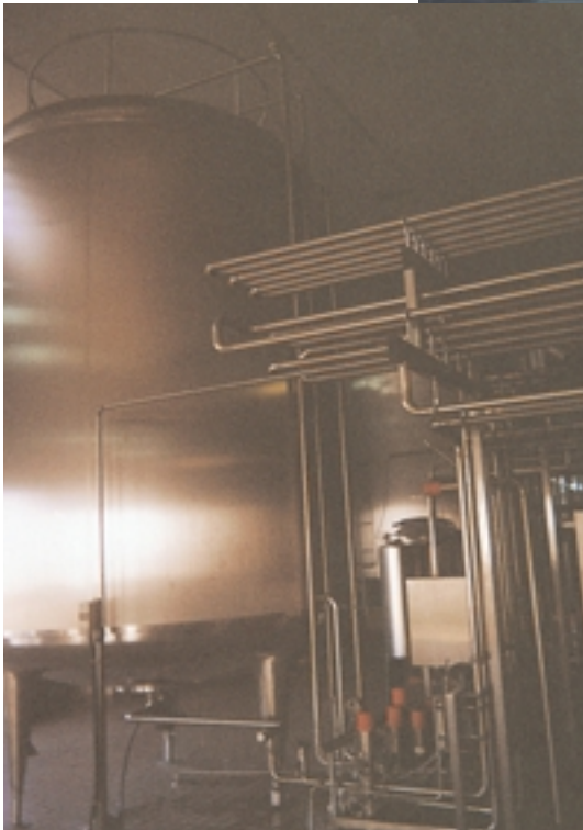
本事業にて購入・設置された市乳処理 プラント（高温殺菌を行っている）
