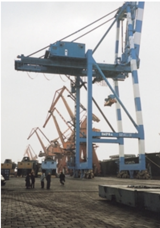
設置された多目的クレーン
