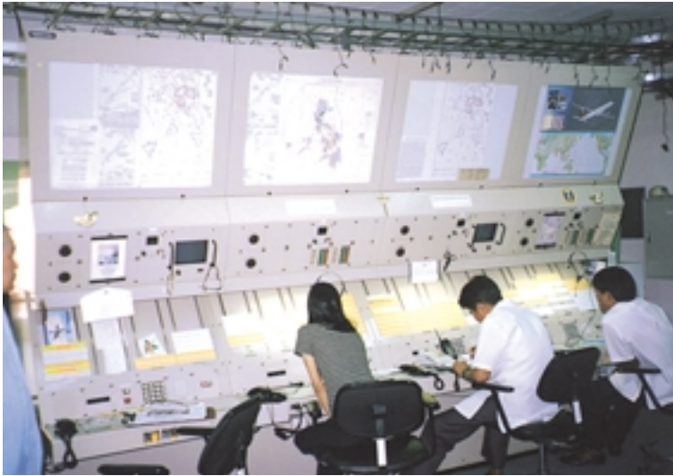
管理棟ビル：サブACCの操作盤
