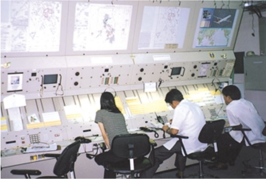
管理棟ビル：サブACCの操作盤
