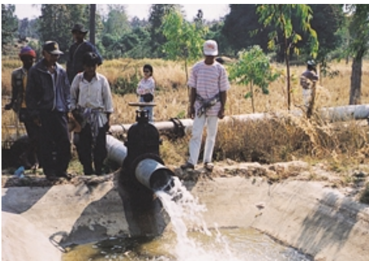
貯水池より配水管にて水を引く
