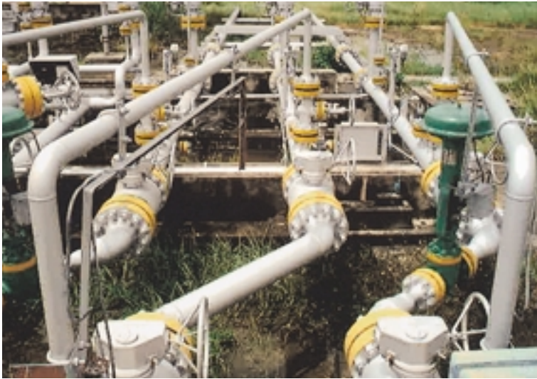
バクラバード・ガス田地上設備
