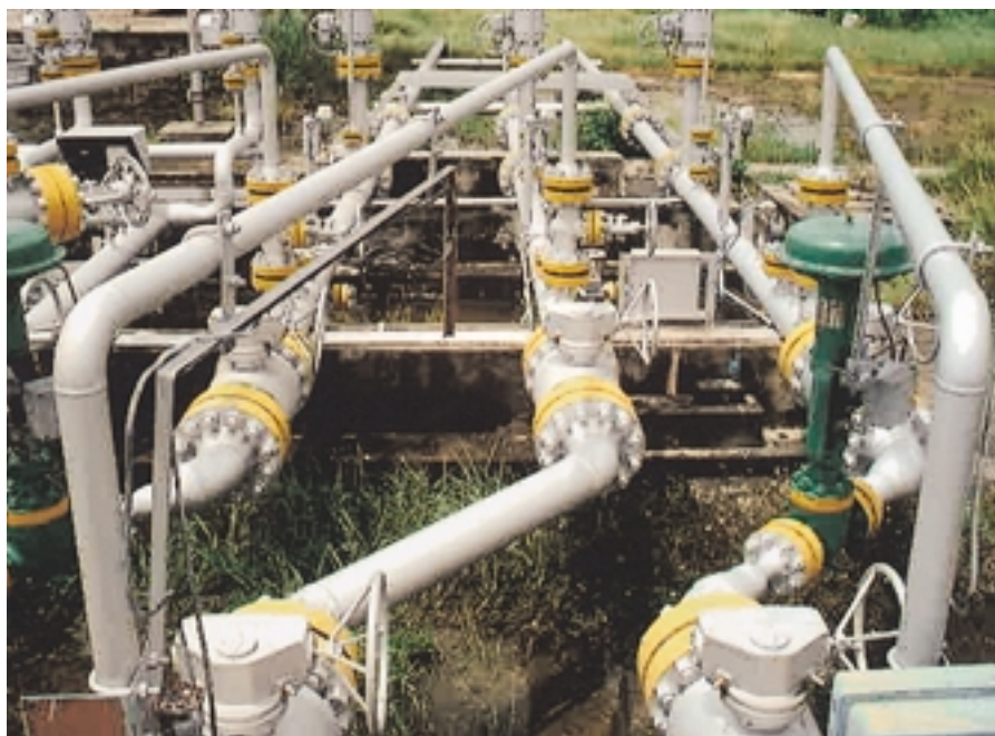
バクラバード・ガス田地上設備
