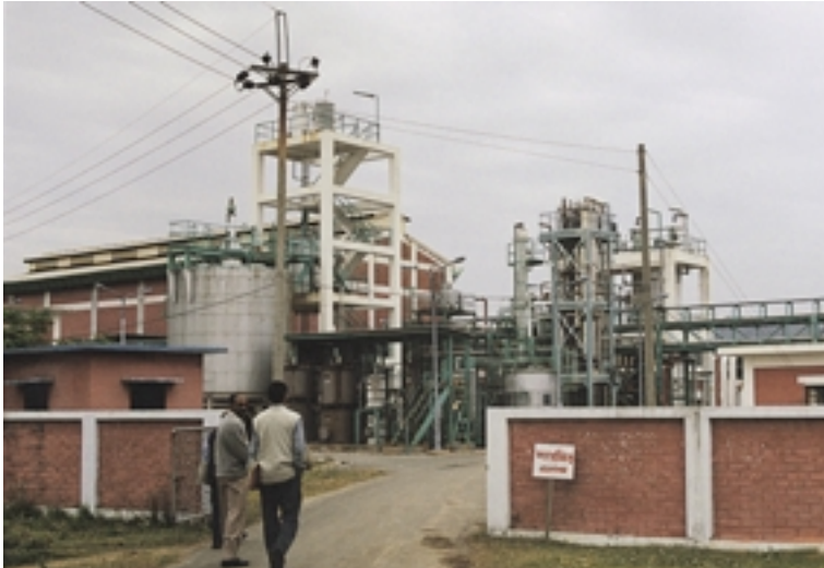
改修・更新後の工場設備
