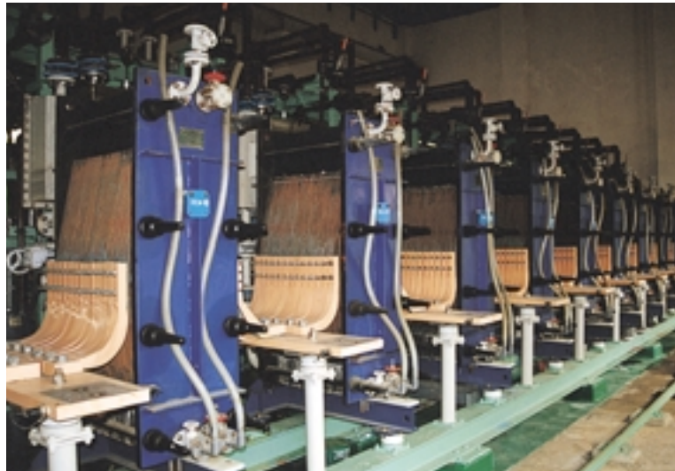
イオン交換膜法による電解設備
