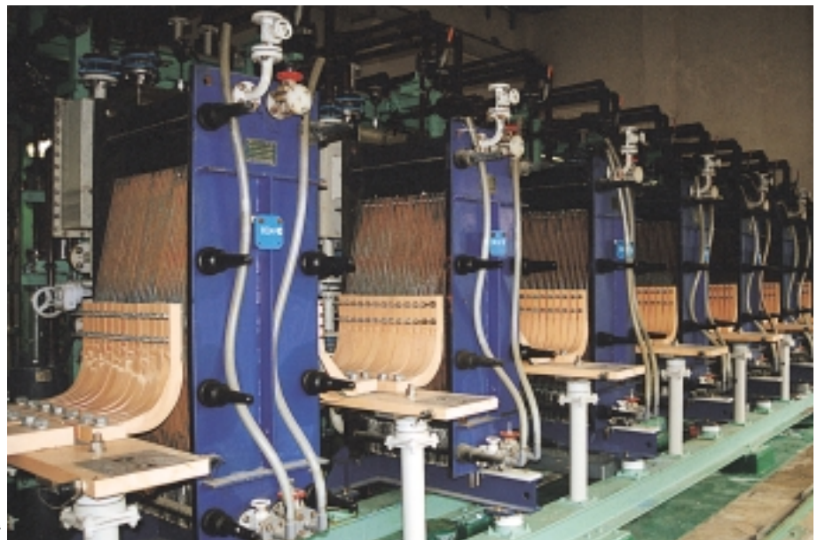
イオン交換膜法による電解設備
