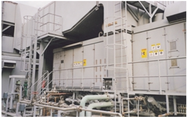
設置されたガスタービン発電機
