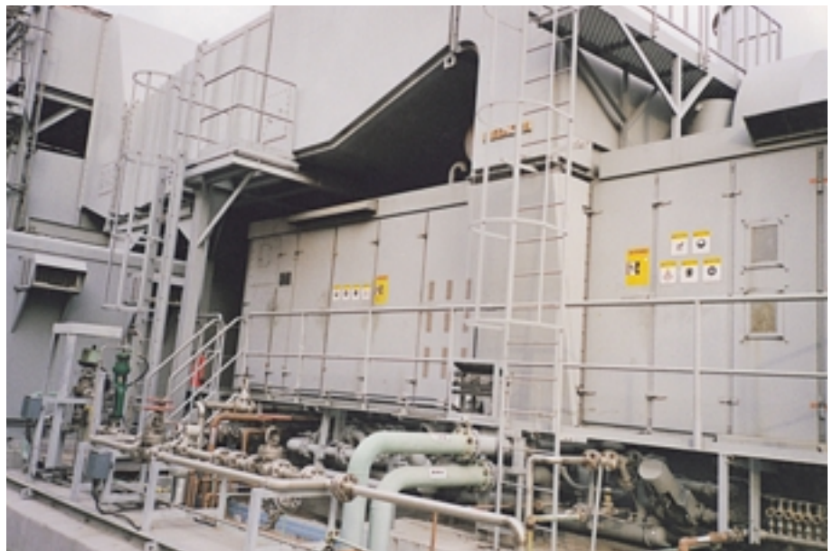
設置されたガスタービン発電機
