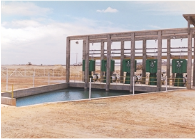
ポンプ場（マリア・テレザ地区）
