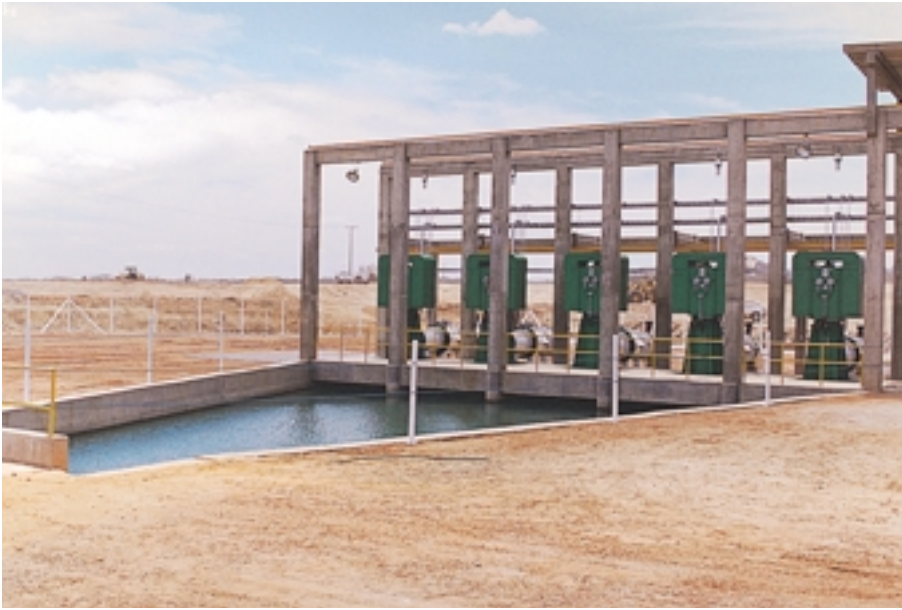
ポンプ場（マリア・テレザ地区）
