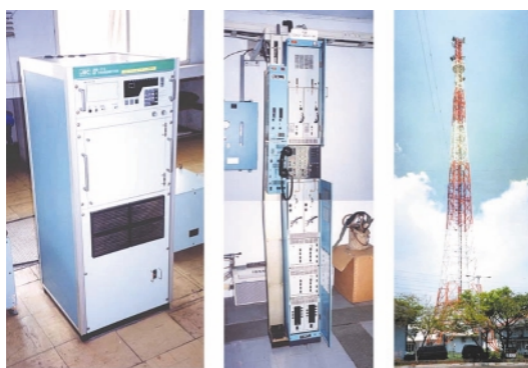
ジャカルタ1級局の調達機器類
